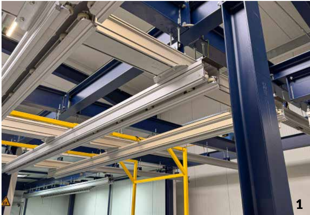
1: Die Rollen des Fördersystems sind innenliegend und gut geschützt. Foto: SWT
