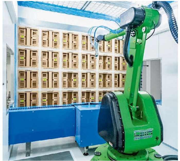
Die Lackierkabine ist mit einem Roboter und einer Trockenabscheidung ausgestattet.
