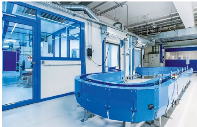
Die installierte Anlagentechnik ist modular aufgebaut.
