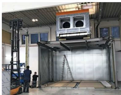
Aktuell erfolgt der Aufbau der Pulveranlage, hier der Blick auf die Montage des Einbrennofens. Foto: Erfal
